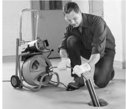
Figura 10 – Ejemplo de cómo extender el desagüe para que el acceso quede a menos de 2 pies (60 cm) de la salida del cable
