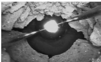
Figura 13 – Agujero que atravesó una alcantarilla
