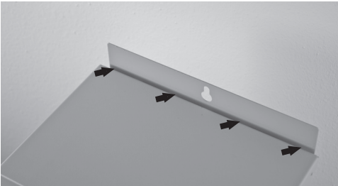
Figura 4 - Espacio entre la cubierta y la placa posterior
