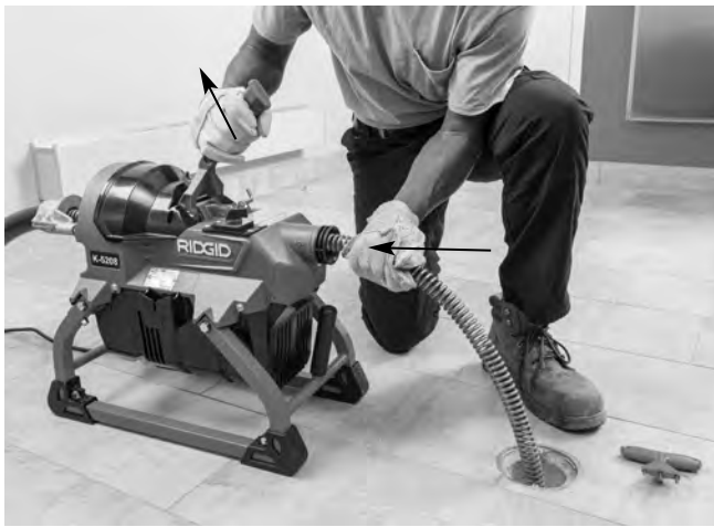
Figure 14B – Réintroduction du câble dans la machine avec embrayage désengagé et câble arrêté
