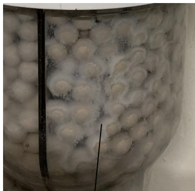
Figure 5 - Précipité de sel déposé sur le média neutralisant des échangeurs de chaleur en aluminium
