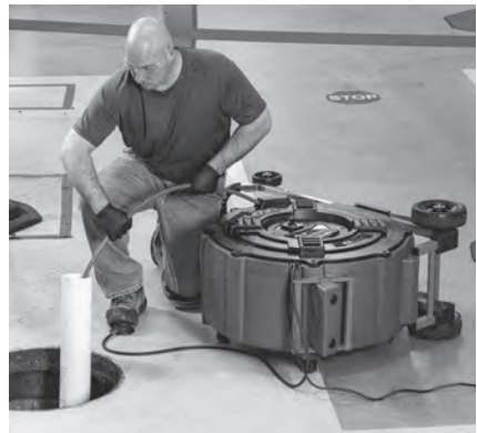
Figura 5 – Ejemplo de cómo extender el desagüe para que el acceso quede a menos de 3 pies de la salida del cable
